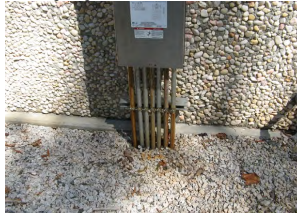
Rust Lighting Panel Conduit
